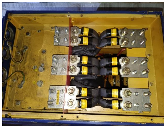
Figura 2. Ausencia de la barra de conexiones en estrella.
