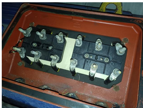
Figura 2. Ausencia de las pletinas de conexión en triángulo
